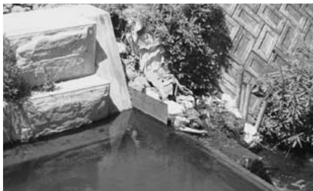
水漏れ頭首工
