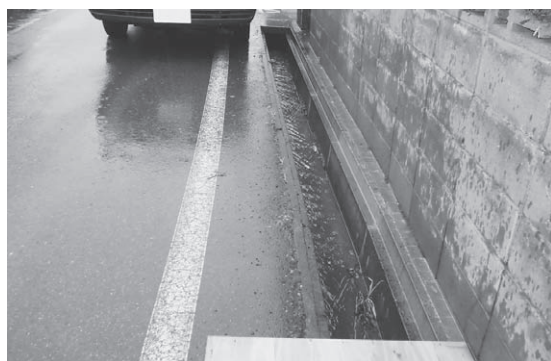
ふたを設置していない危険な側溝
