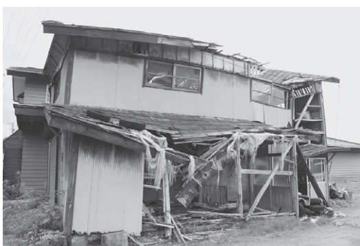
倒壊の危険がある空き家
