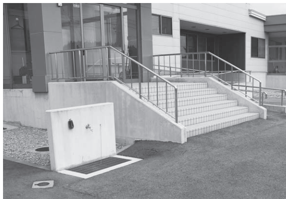
地盤沈下、建物への影響は
