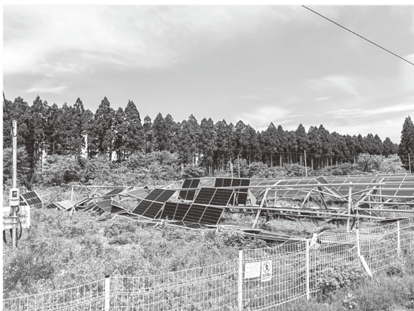
内鯉川地区で倒壊していた太陽光発電施設
