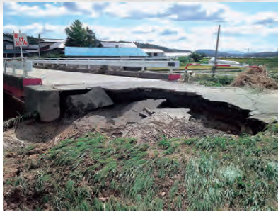
崩壊した町道（長面）
