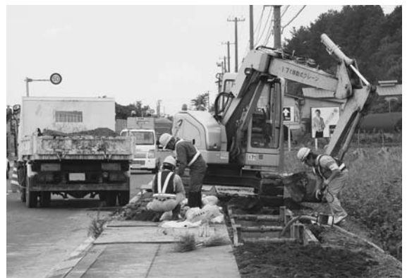
▲快適な生活のために下水道を整備
